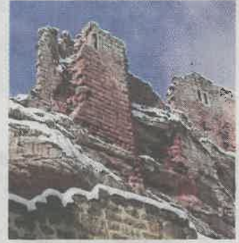
Le pan de mur du logis nord avant sa consolidation en 2014. DOCUMENT REMIS
